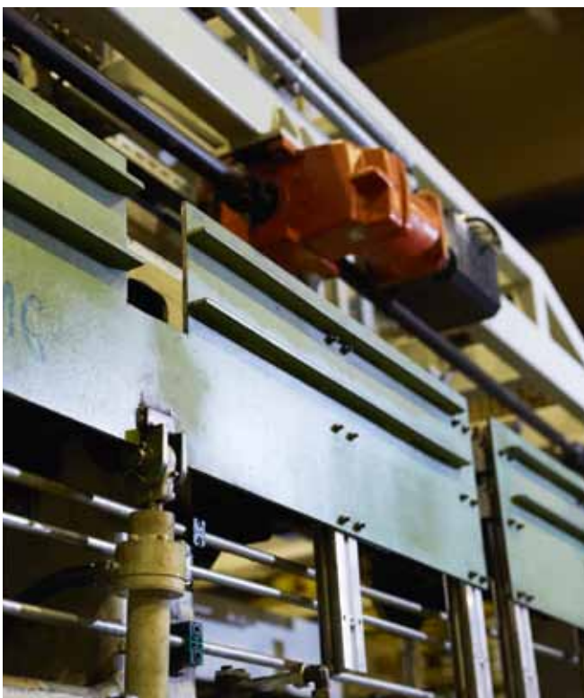
▲ Unfall 003: Flutsch, da lagen sie. Zum Glück war niemand auf dem Gehweg, als diese vier Blechtafeln aus einer Höhe von fast drei Metern vom Stapel fielen. Inzwischen wurde an der automatischen Stapelvorrichtung eine Schutzvorrichtung angebracht.
